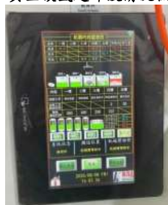
設備操作介面
