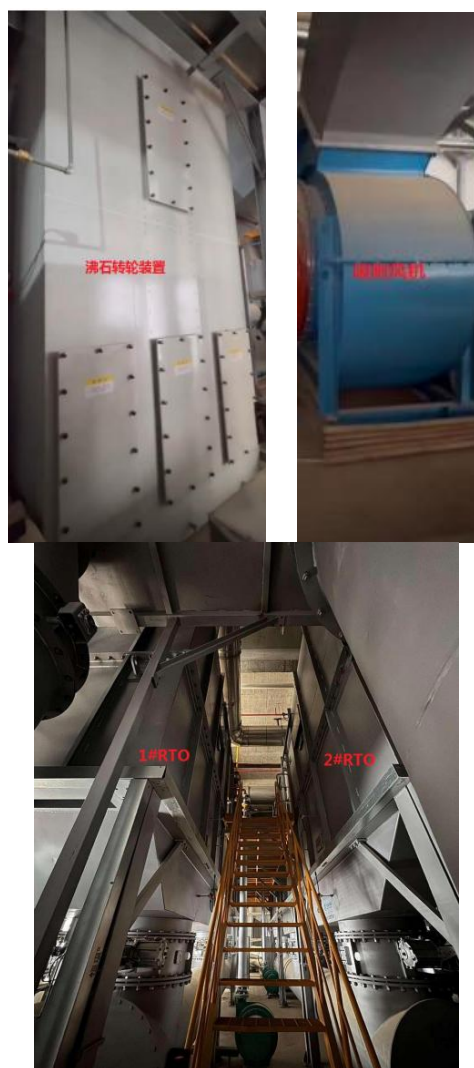
沸石吸附轉輪濃縮及蓄熱式熱氧化設備
