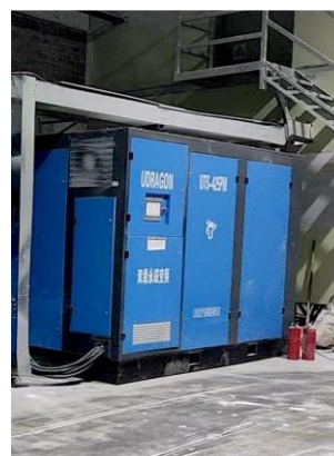
中央空壓系統及1台315kW空壓機
