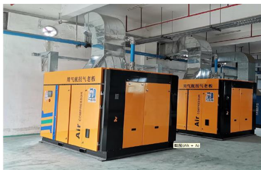
2 台 75kW 及 2 台 110kW 空壓機
