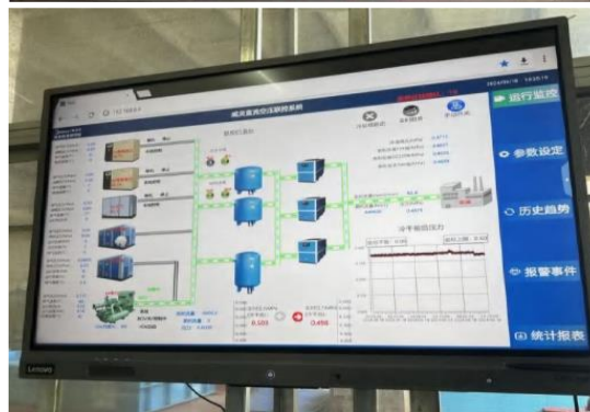
中央空壓系統操作介面
