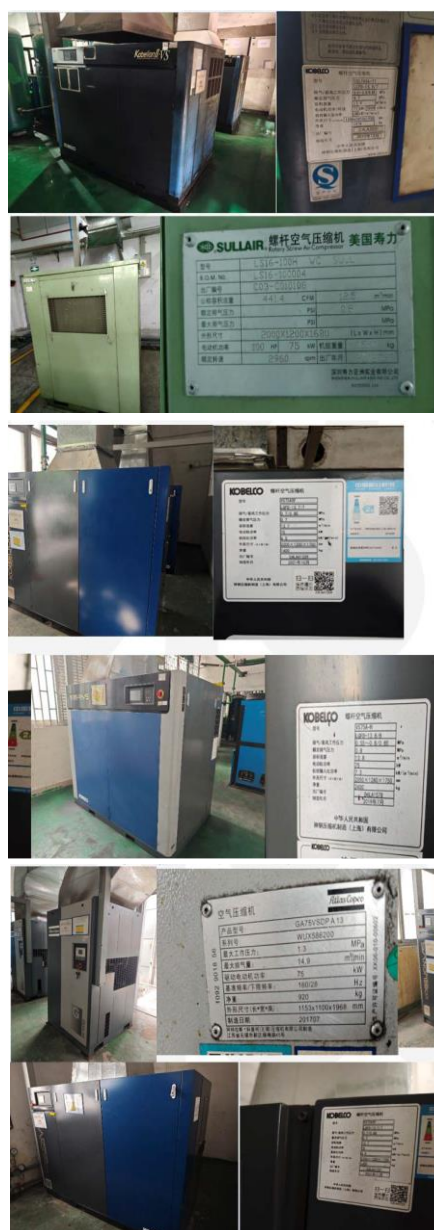
10 台 75kW, 1 台 132kW 及 1 台 160kW 空壓機
