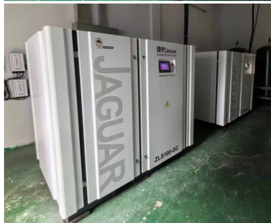
2 台 75kW 及 2 台 37kW 空壓機
