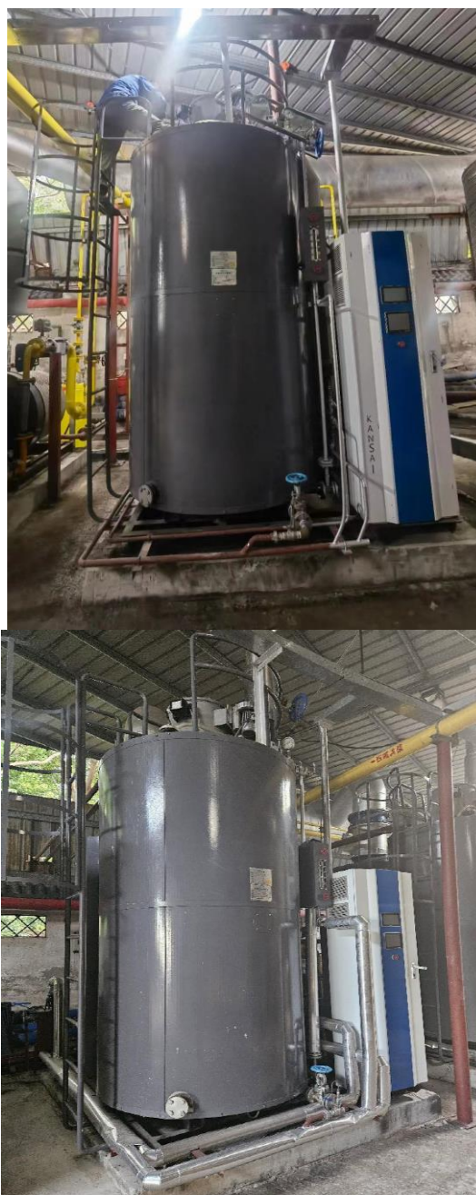
低氮燃燒器燃氣鍋爐
