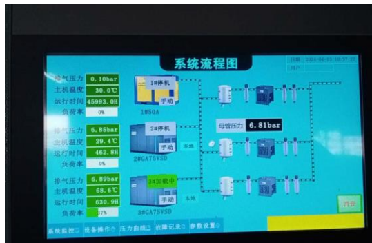
中央空壓系統操作介面
