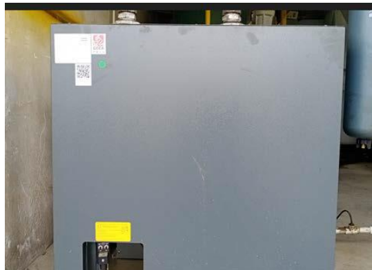
2 台 75kW 空壓機及冷乾機
