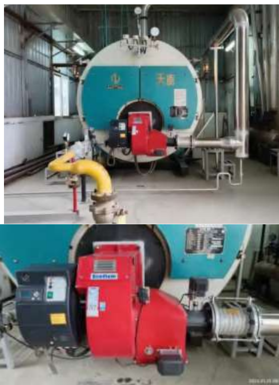
低氮燃燒器燃氣鍋爐
