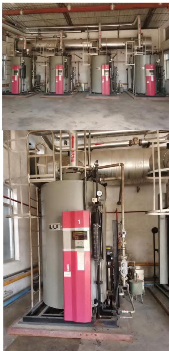
低氮燃燒器燃氣鍋爐
