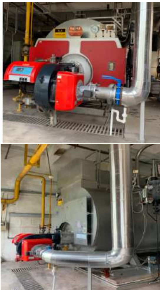
低氮燃燒器燃氣鍋爐
