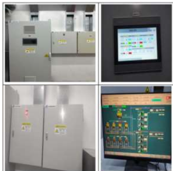
BMS 控制系統及操作介面
