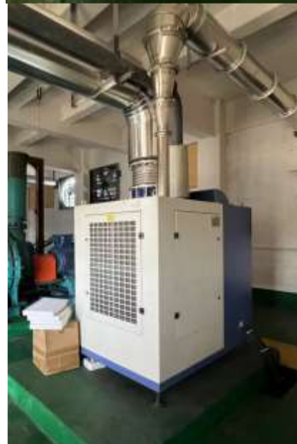
2 台 160kW 無油磁懸浮離心式鼓風機
