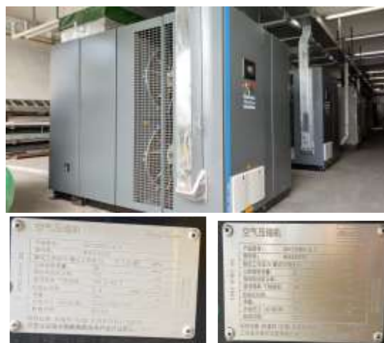
2 台 132kW 空壓機
