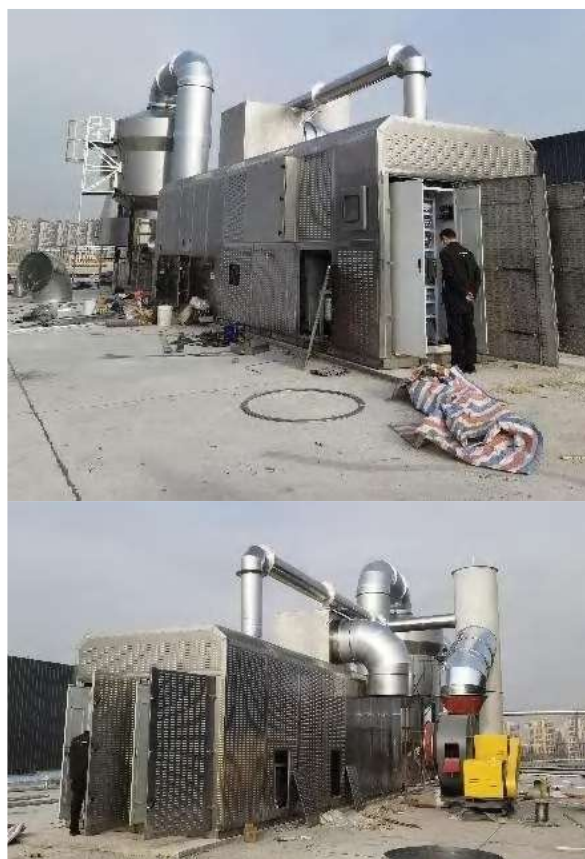
沸石吸附轉輪濃縮及催化燃燒設備
