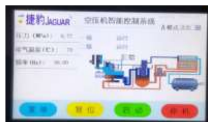
空壓機操作控制屏
