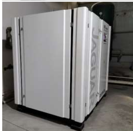
1 台 75kW 兩級壓縮螺桿空氣壓縮
