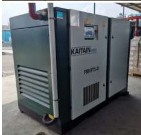
3 台 75kW 兩級壓縮螺桿空氣壓縮
