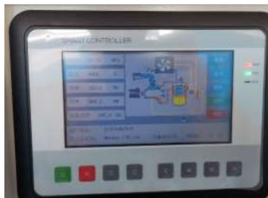
空壓機操作控制屏
