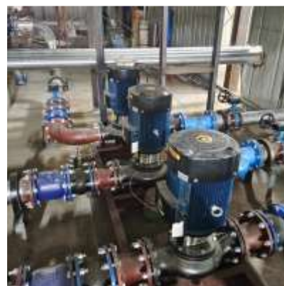
中央空調水泵
