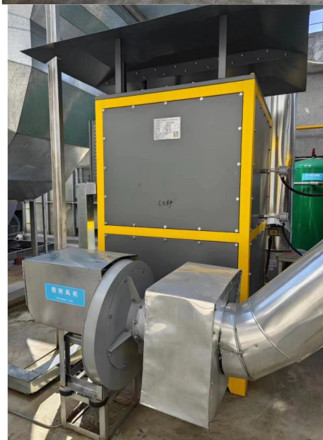
活性炭吸附濃縮及催化燃燒設備
