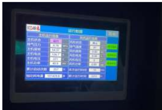
空壓機操作控制屏
