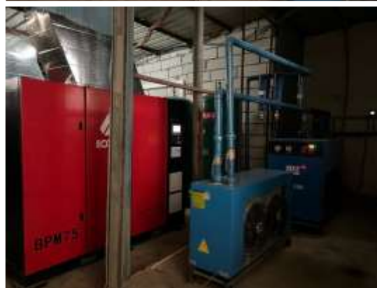
2 台 75kW 兩級壓縮螺桿空氣壓縮
