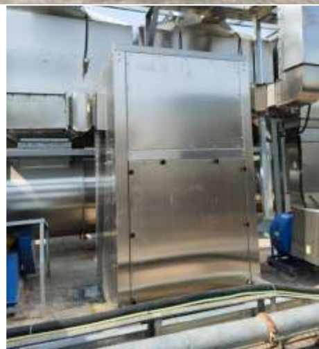
活性炭吸附濃縮及催化燃燒設備
