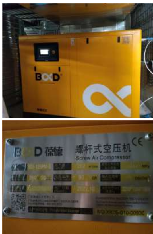
1 台 90kW 兩級壓縮螺桿空氣壓縮
