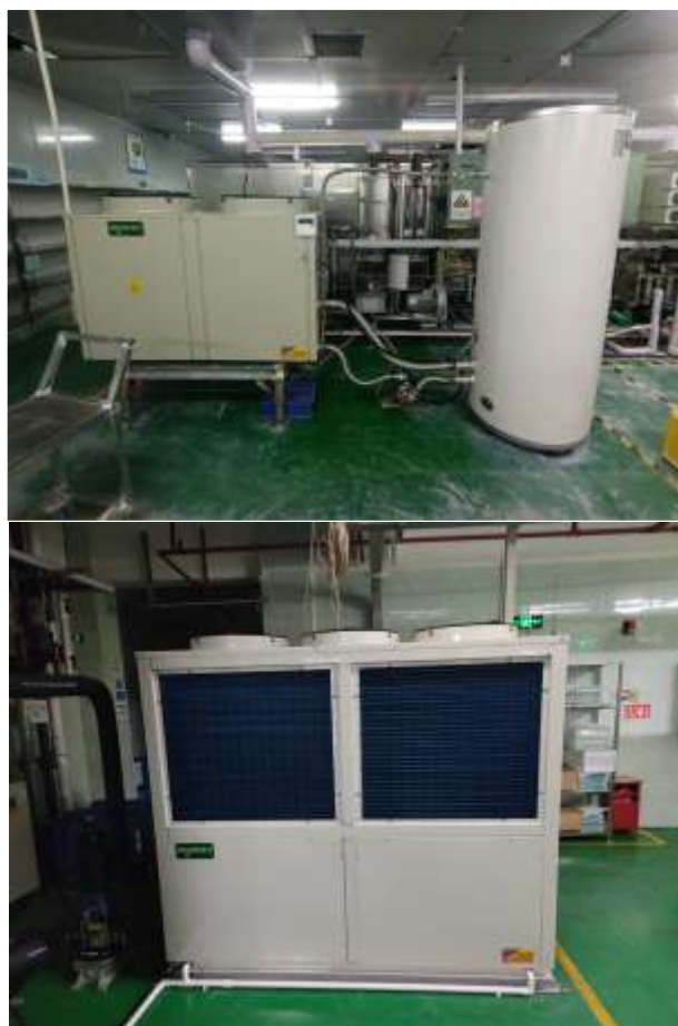
5 台熱泵用於預熱熱水
