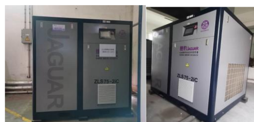
4 台 55kW 兩級壓縮螺桿空氣壓縮
