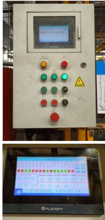
廢氣處理系統電控箱
