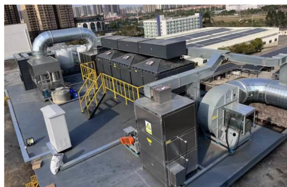
活性炭吸附濃縮及催化燃燒設備
