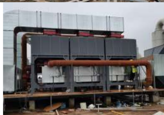
活性炭吸附濃縮及催化燃燒設備
