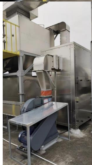
活性炭吸附濃縮及催化燃燒設備
