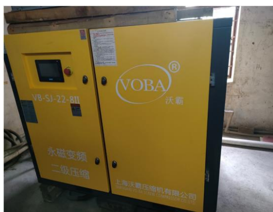
1 台 22kW 兩級壓縮螺桿空氣壓縮
