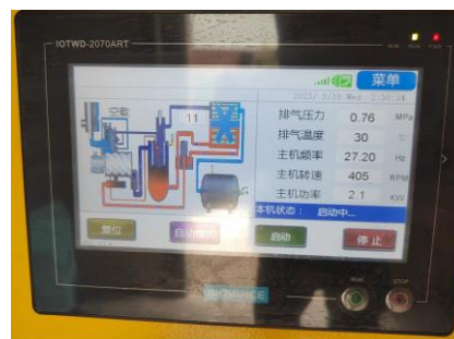
空壓機操作控制屏
