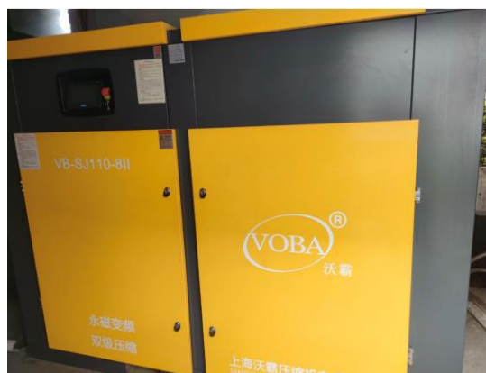
1 台 110kW 兩級壓縮螺桿空氣壓縮機
