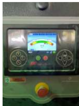
空壓機操作控制屏
