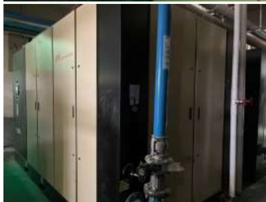
2 台 200kW 兩級壓縮螺桿空氣壓縮
