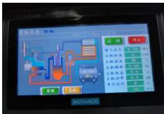
空壓機操作控制屏
