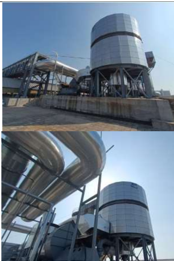
沸石吸附轉輪濃縮及蓄熱式熱氧化廢氣系統
