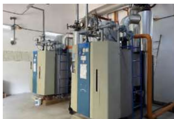
2台 2t/h 燃氣鍋爐
