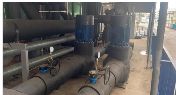
中央空調水泵
