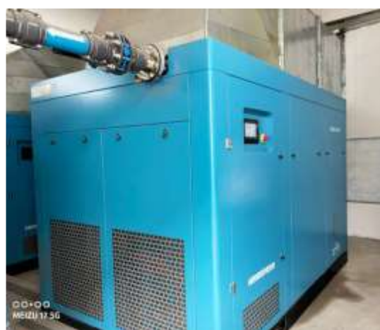
1 台 132kW 兩級壓縮螺桿空氣壓縮機
