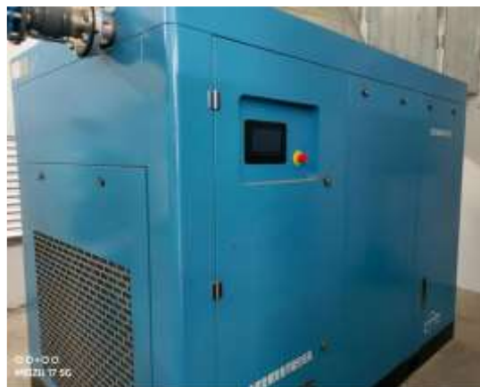
1 台 90kW 兩級壓縮螺桿空氣壓縮機
