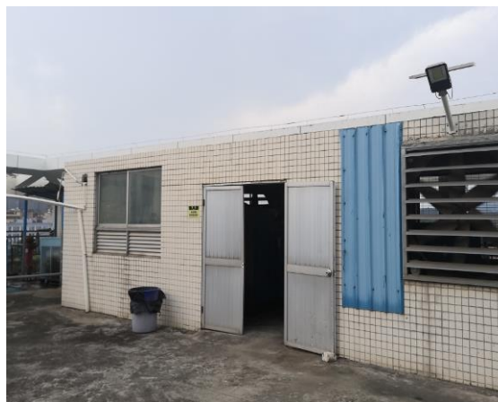
空氣壓縮機機房
