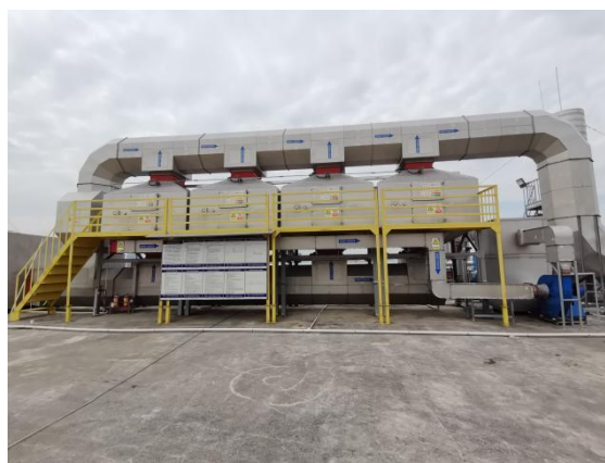
活性炭吸附濃縮及催化燃燒設備
