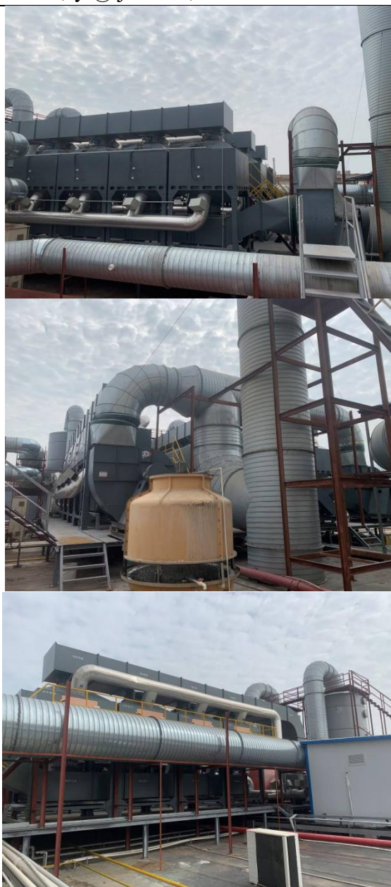
活性炭吸附濃縮及催化燃燒設備
