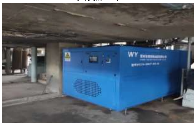
1 台 210kW 無油磁懸浮離心式熱油泵
