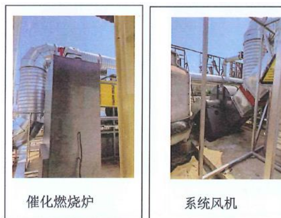
催化燃燒設備
