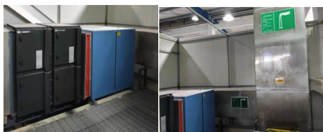
紫外線光解及活性炭吸附設備
