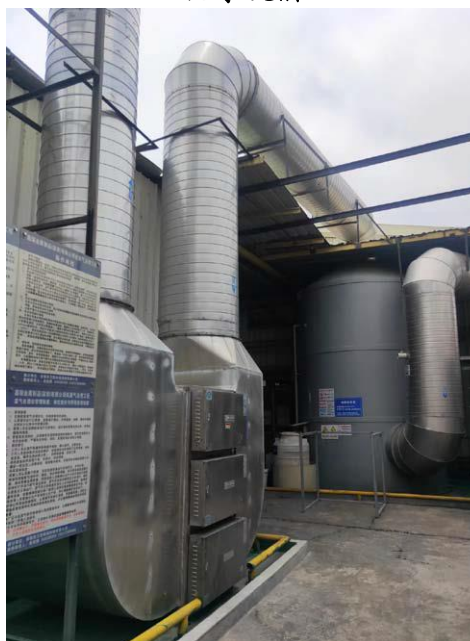
靜電煙氣淨化裝置
