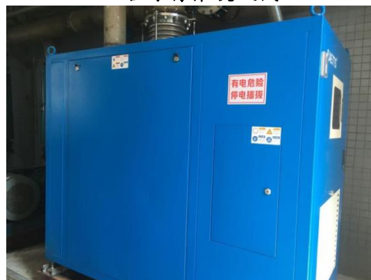
2 台 110kW 無油磁懸浮離心式鼓風機
