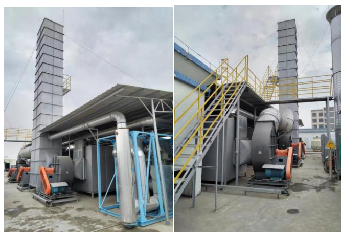
活性炭吸附濃縮及催化燃燒設備
