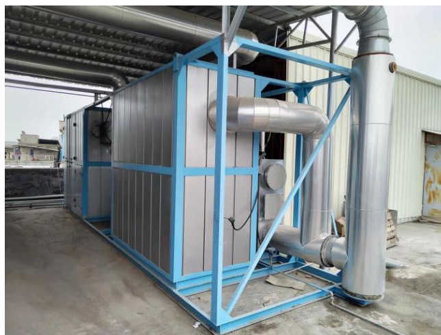
催化燃燒設備
