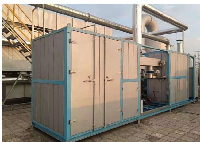
催化燃燒設備
