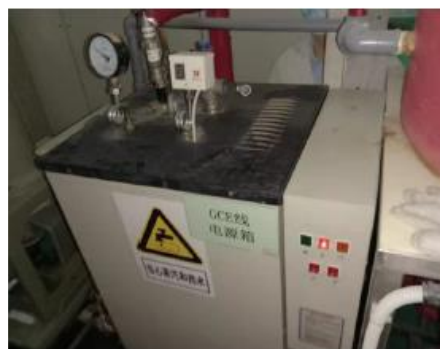
原有電鍍線加熱鍋爐
