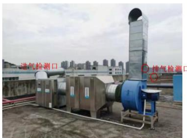
紫外線光解及活性炭吸附設備
