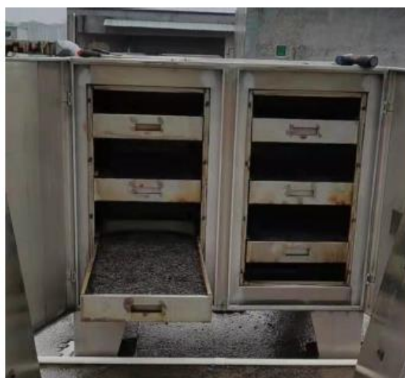
活性炭吸附設備
