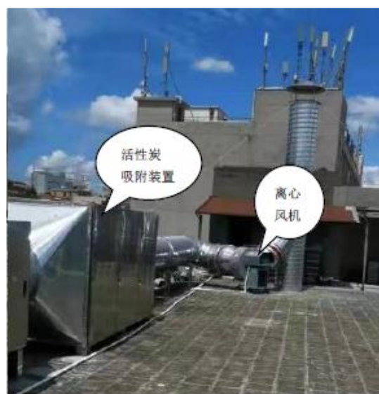
活性炭吸附濃縮設備
