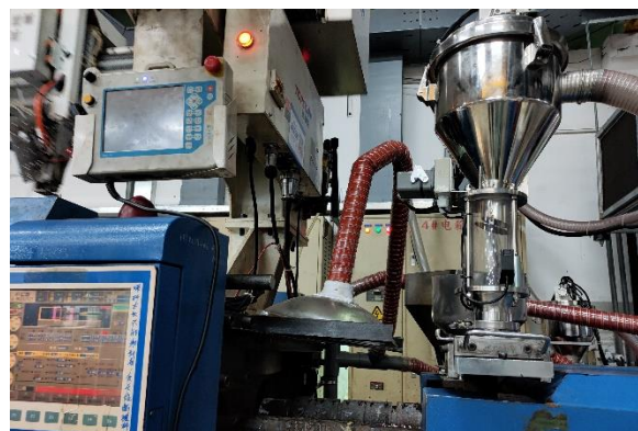
注塑車間廢氣收集
