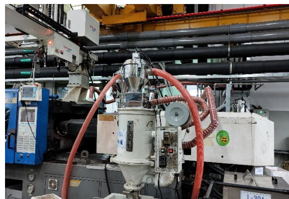
注塑車間廢氣收集
